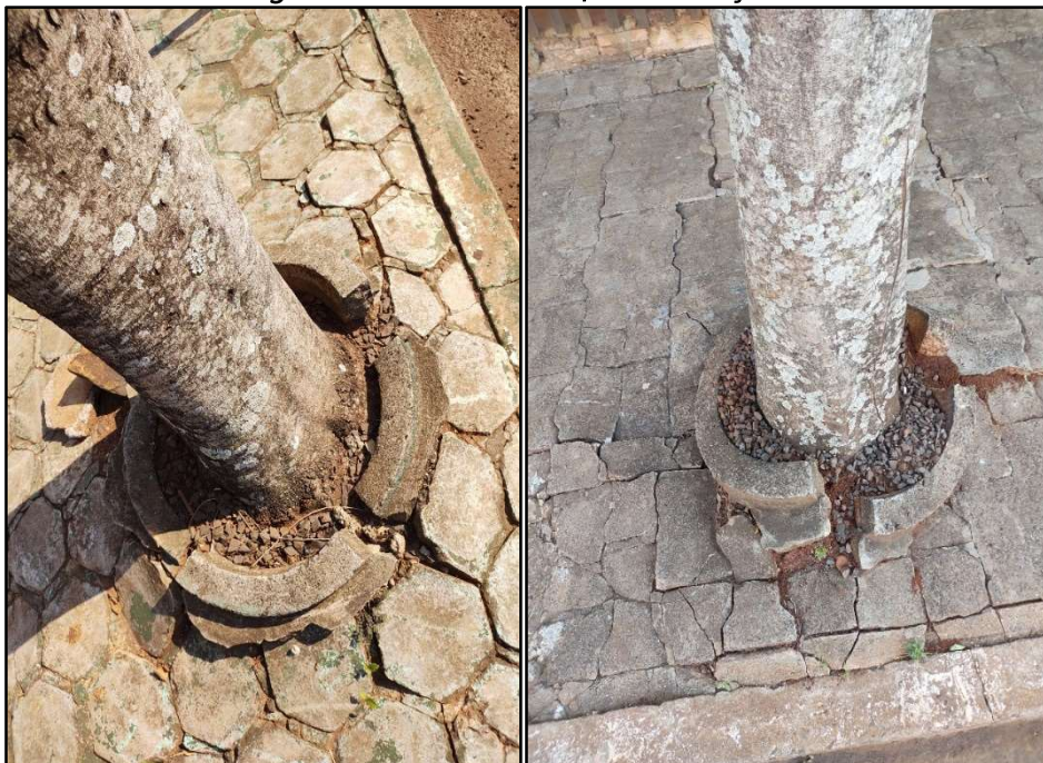
Figura 34 – Árvores danificando calçadas.
